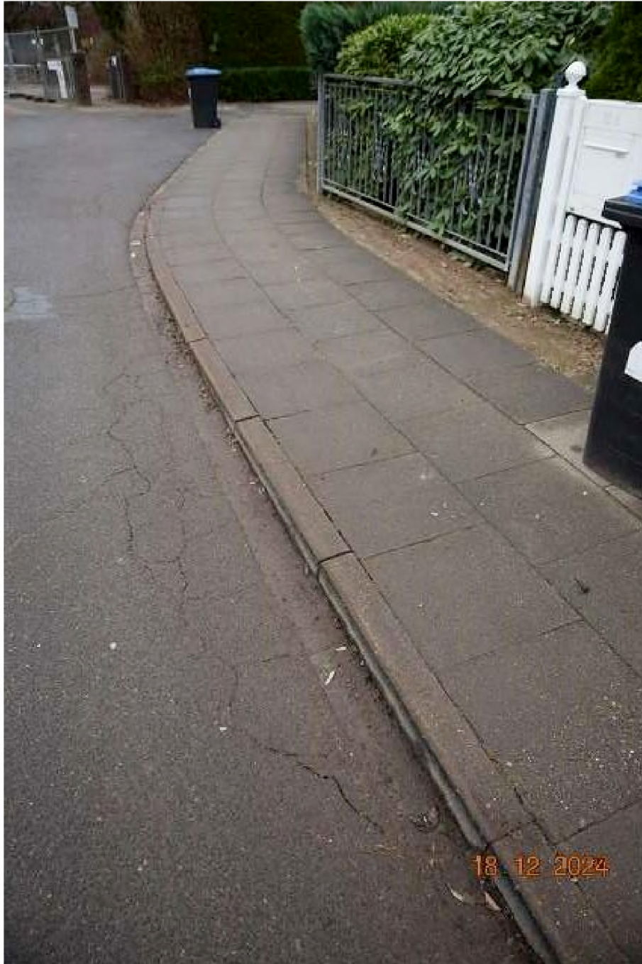
Foto Nr. 1/05 – Nahaufnahme zu Foto Nr. 1/04 – Rissbild Asphaltdecke, Fugenwerk Bordstein
