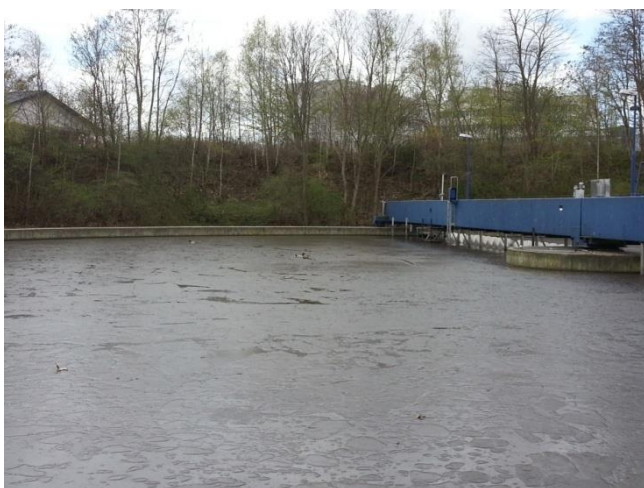
Nachklärung (Absetzbecken für Klärschlamm)
