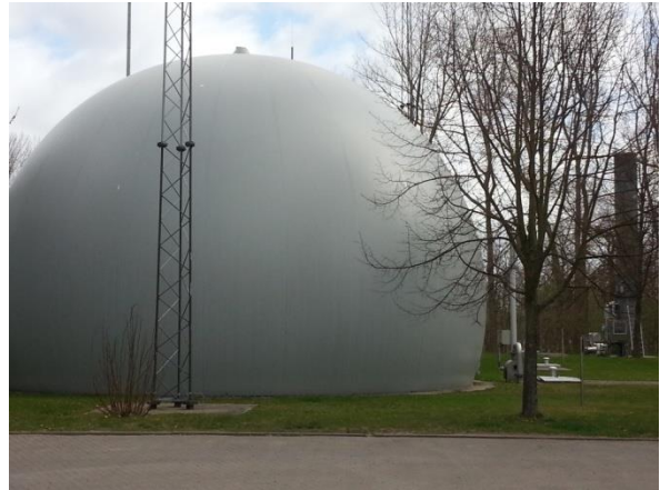
Zwischenspeicher (Druckbehälter) für Biogas
